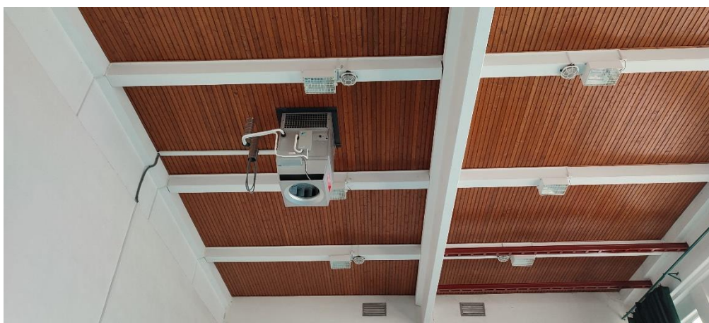
Obrázok č.22 Teplovzdušná jednotka Roofvent v telocvični
