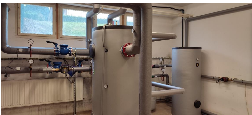
Obrázok č.19 Akumulačný zásobník vykurovacej vody
