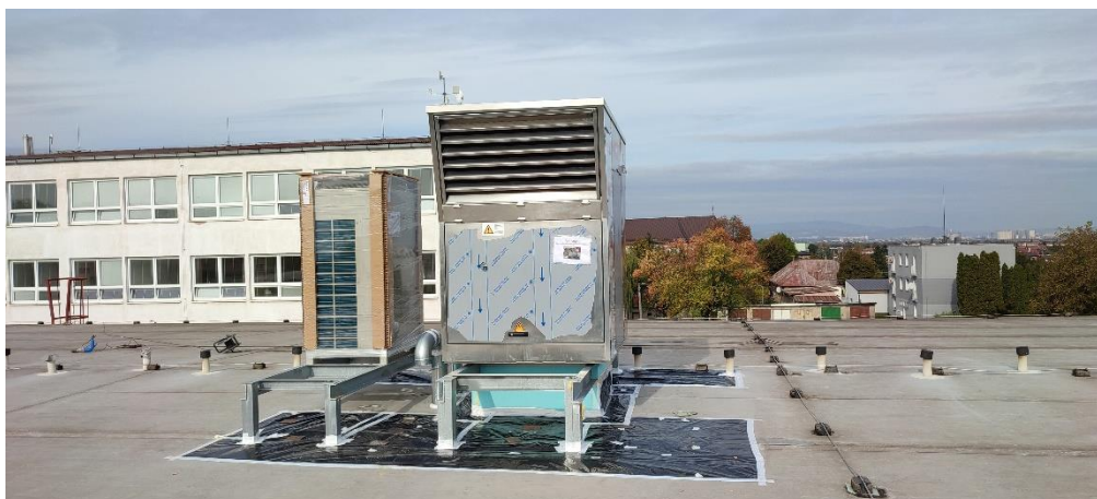
Obrázok č.21 Elektrické tepelné čerpadlo a jednotka Roofvent
