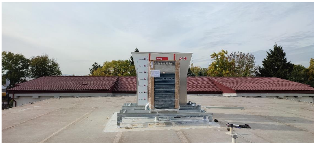
Obrázok č.20 Elektrické tepelné čerpadlo a jednotka Roofvent
